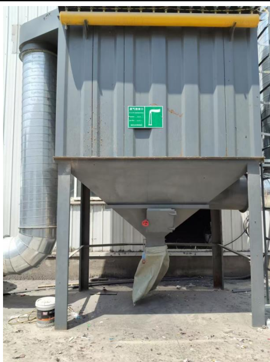
DA001 号排气筒
